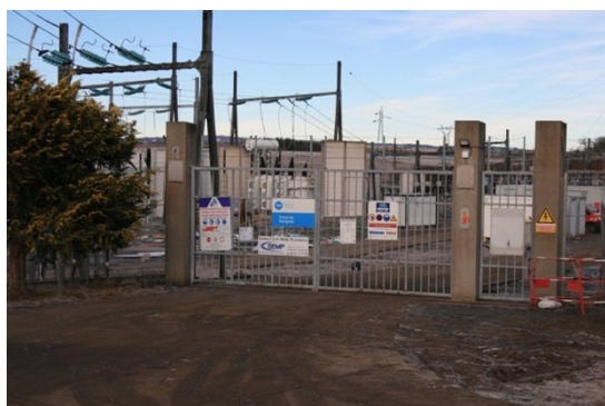
Poste électrique de SAVIGNAC.
