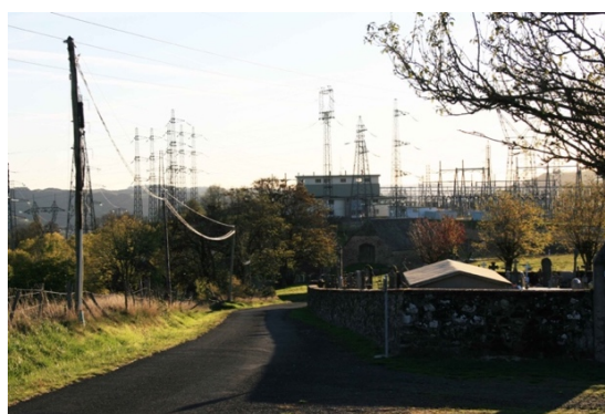
Abords du poste électrique de RUEYRES.
